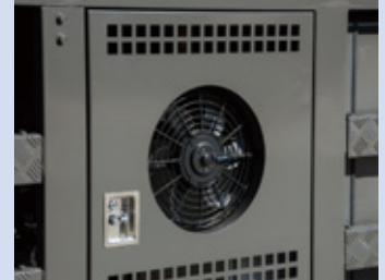
냉각팬 추가 설치 전기장치의 과열방지 및 시스템 보호를 위한 냉각팬 추가 설치
